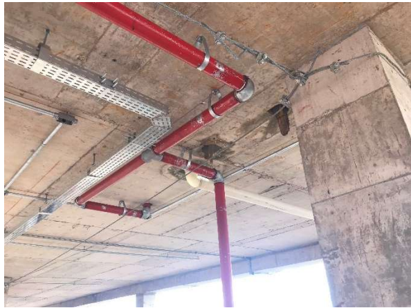
11 – Tubulação de hidrantes, águas pluviais, calhas de instalações elétricas e CFTV, 2ºpav.
