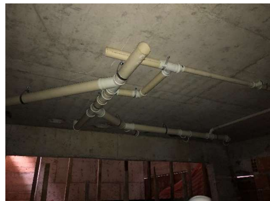
16 – Instalações de esgoto sanitário.
