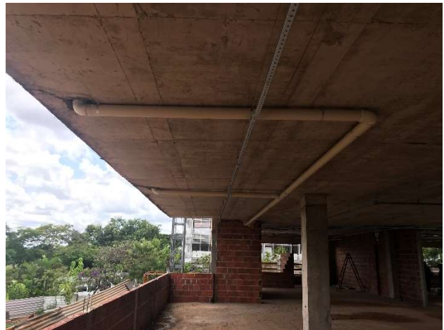
12 – Tubulação de águas pluviais, e calha de instalações elétricas, 1ºpav.
