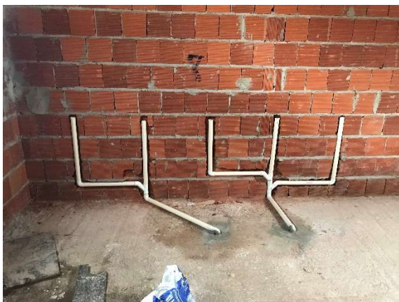
15 – Instalações de esgoto sanitário.
